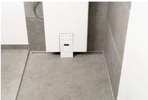
Billede 3: Indsugning ved gulv (linjeafløb)
